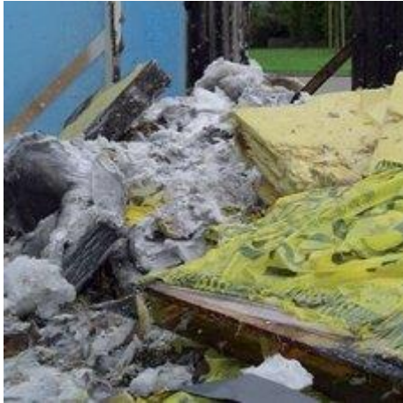
Brandresten glaswol na gevelbrand. Alles brandt, ook glaswol!
